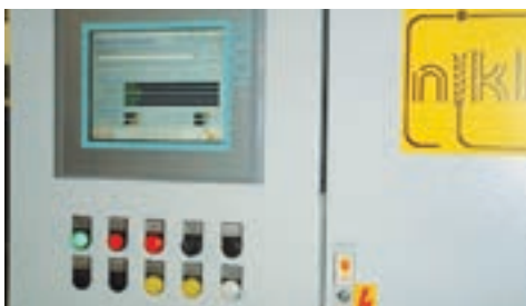
Електрощит керування з сенсорним екраном
